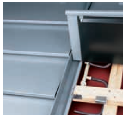
Abb. 19: Verrohrung mit flexiblen Verbindungsschläuchen
