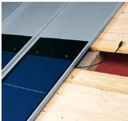
Abb. 32: Montiertes Solar PV-Modul vor der Befestigung; Befestigung s. Abb. 24 und Abb. 29, Montage/Befestigung
